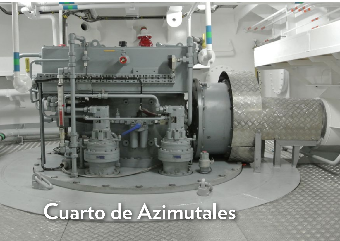
Cuarto de máquinas
